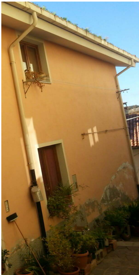
Il degrado dei prospetti
