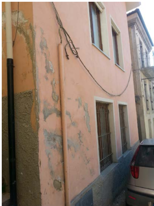
Il degrado dei prospetti
